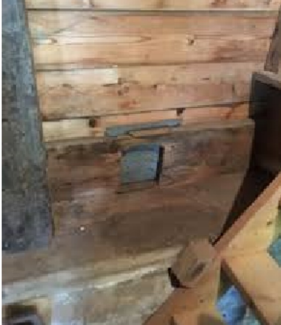
Beeld van de aangetaste planken gezien vanaf de binnenkant. (Foto: Stichting De Wijhese Molen)
